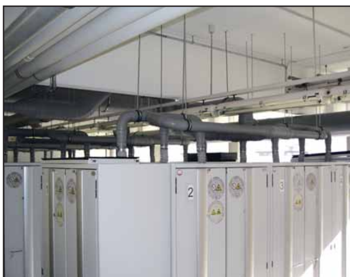
Sistema di ventilazione con canalizzazione esterna
