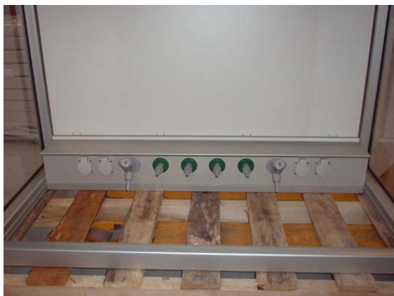
Vue de face du poste de travail utilisant des matières dangereuses avec différents moyens de raccordement. Sans soubassement ni surface de travail
