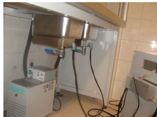
Anschluß der Ultraschallbecken an die Stromversorgung
