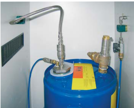
Innenansicht Schrank mit Behälter für Lösemittel
